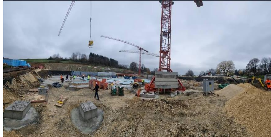
Danach war die Firma Leonard Weiß mit der Freilegung und Schalung der Pfahlköpfe beschäftigt. Dabei werden nach ausreichendem Erhärten des Betonpfahls diese mit einem Bagger freigelegt...
