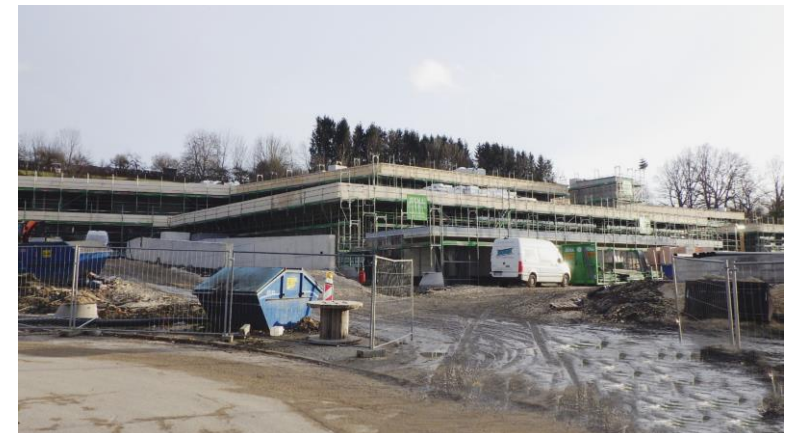
Blick von der Baustellenzufahrt auf das Freibadgebäude und das Kleinkinderplanschbecken. Anlieferrampe und Rutschenturm sind gut sichtbar.
