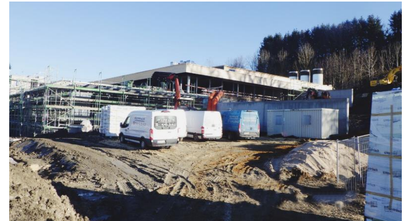
Blick von Westen auf das Gebäude und die südwestliche Stützmauer. Die Lüftungstürme sind bereits auf dem Dach montiert.
